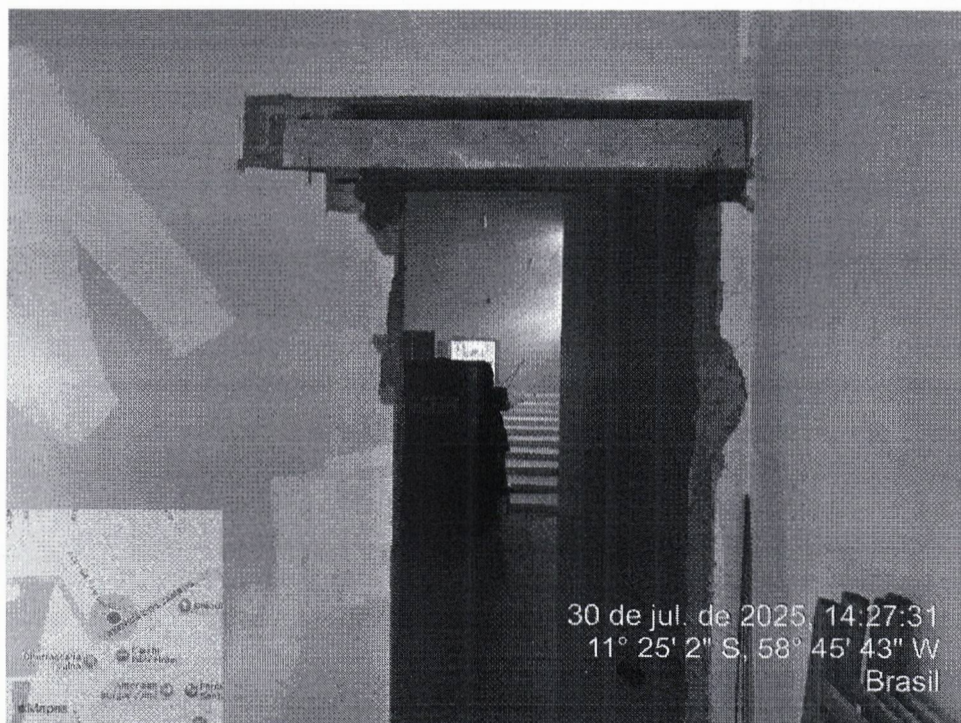
Foto 8 – verga e contraverga, itens 1.1.5 e 1.1.7 Fonte: Prefeitura Municipal de Juína
